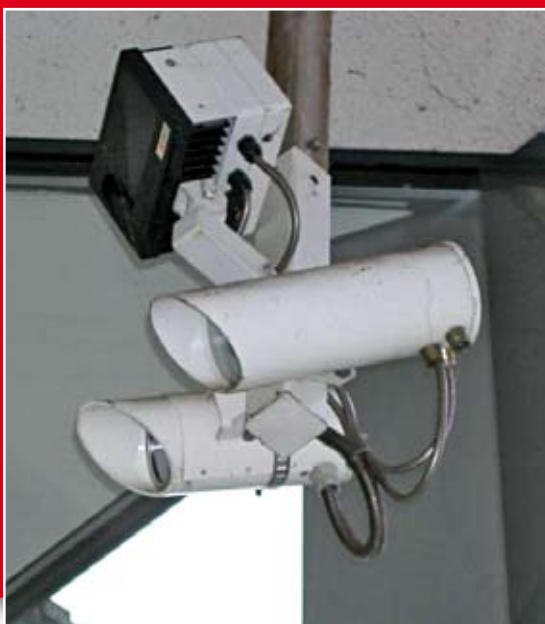
1. kép – Infragugázóval, és kamerával szerelt kültéri PIR
